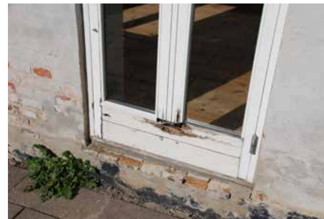
Havnevej 46 - manglende udvendig vedligeholdelse
